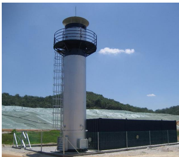
图 3.1-13 封闭式火炬现场设备
