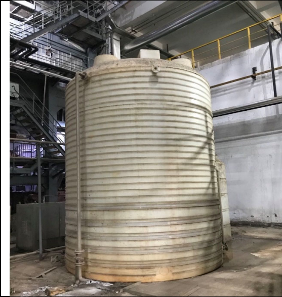
尿素制备储罐
