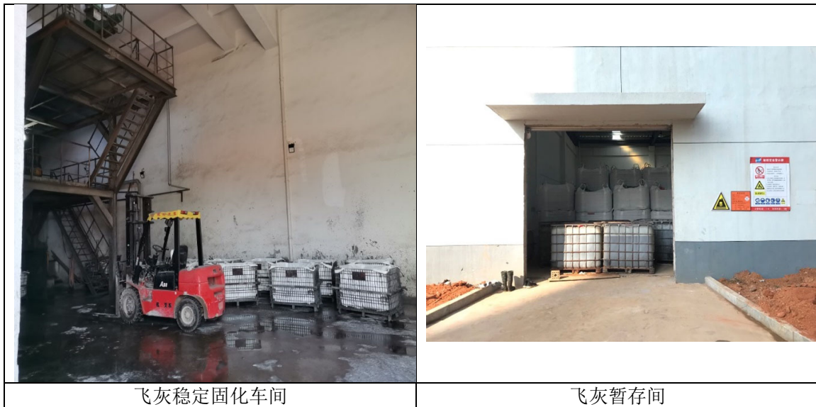
图 4.1-7 固体废物处置设施
