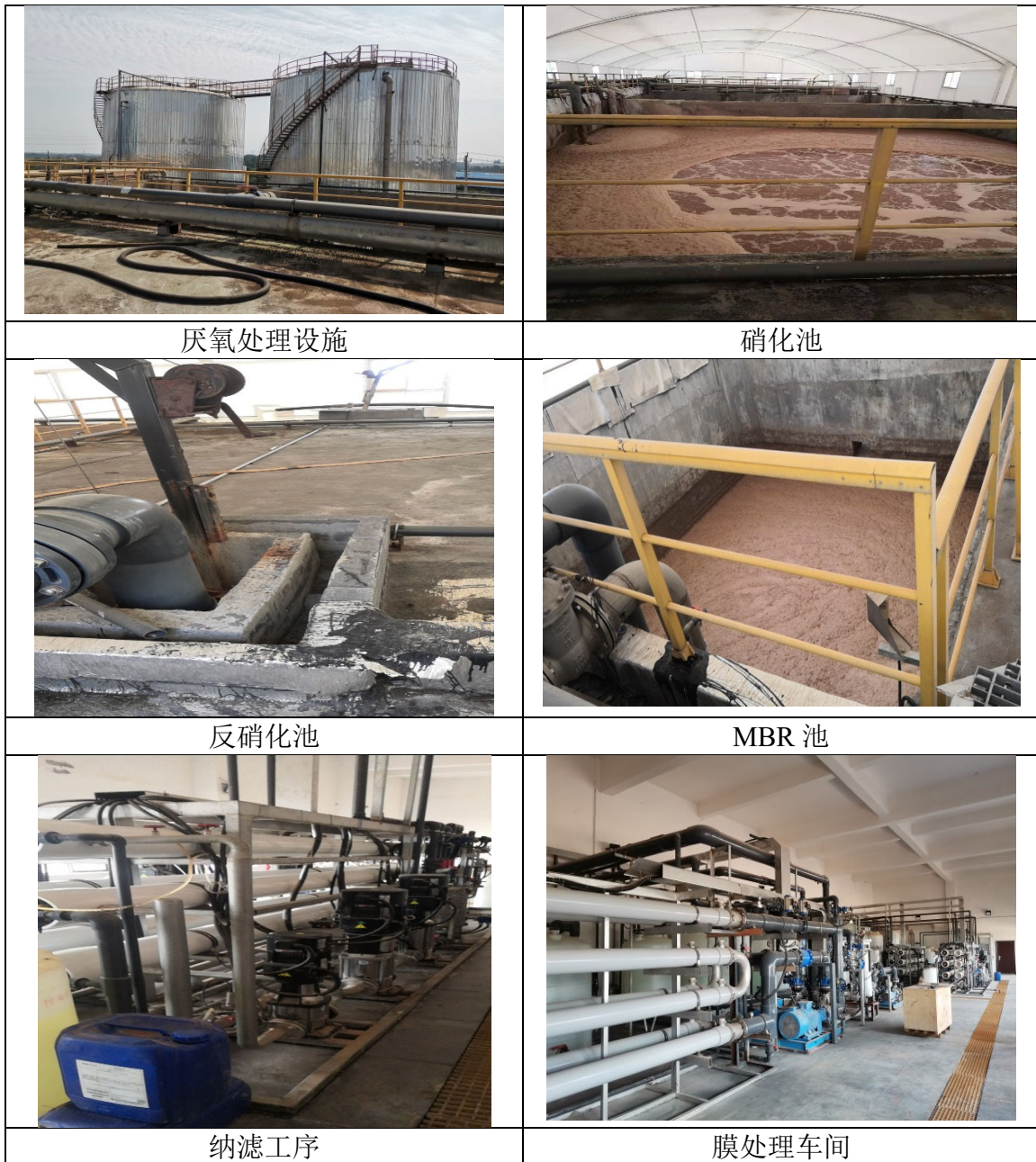
4.1-2 主要生产废水治理设施图
